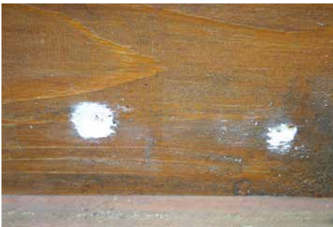
Hat der Specht dennoch zugeschlagen lassen sich die Spechtschäden sehr gut mit Acryldichtmasse aus dem Baumarkt ausbessern. Diese Masse kann man nach dem Trocknen schleifen und überstreichen.
